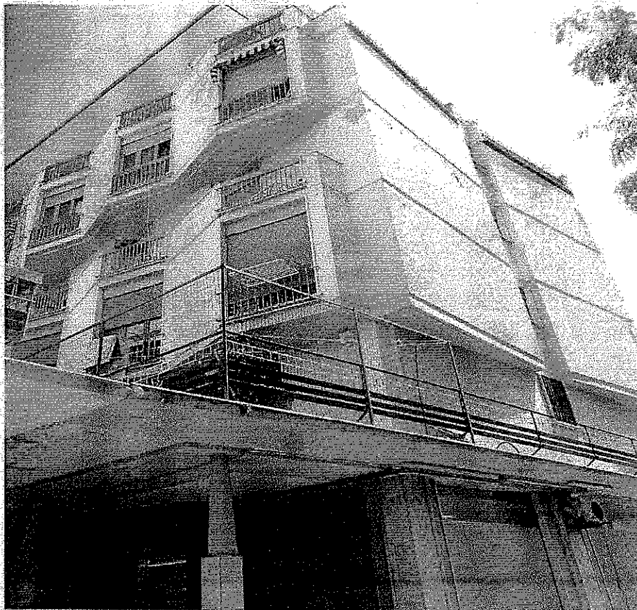
Facciata e intradosso pensiline e terrazze da ristrutturare
