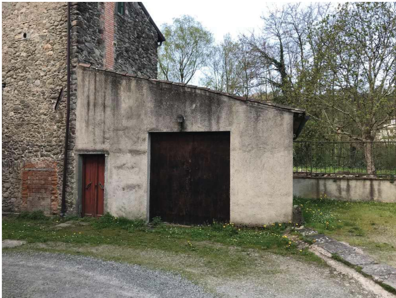
Foto E13: Zone garage e magazzino. Via S.s. della Cisa, Comune di Pontremoli (MS), Frazione Borgo Santissima Annunziata. Lotto 001.
