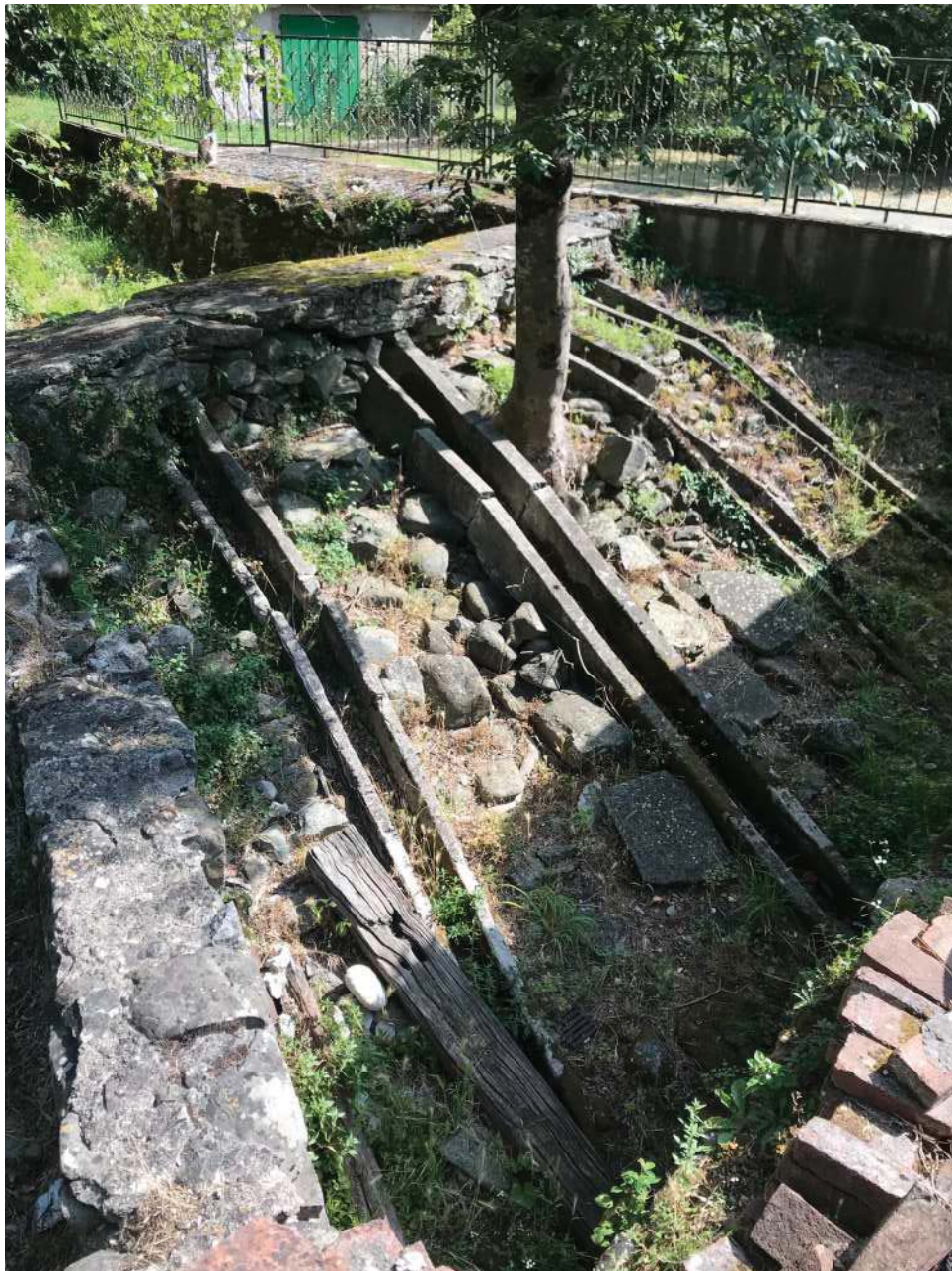
Foto E10: Rudere del mulino e resti dei canali d'acqua. Via S.s. della Cisa, Comune di Pontremoli (MS), Frazione di Borgo Santissima Annunziata. Lotto 001.
