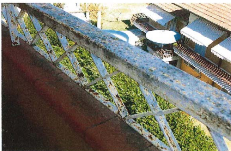
Particolare del parapetto (presenza di muschi sulla muratura, e di ruggine sulla parte in ferro)
