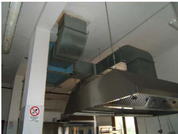
foto 1 Impianto aspiratore di fumi
