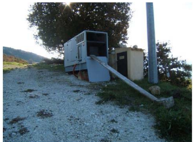
foto 12 Impianto gruppo elettrogeno
