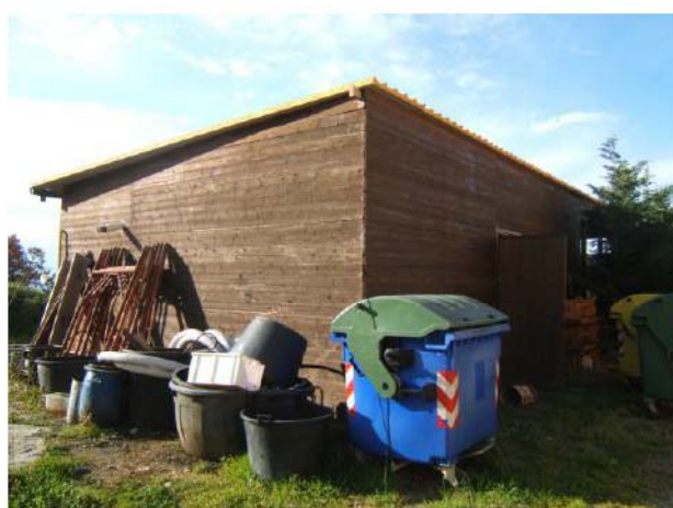
foto 4 Vano tecnico vista posteriore
