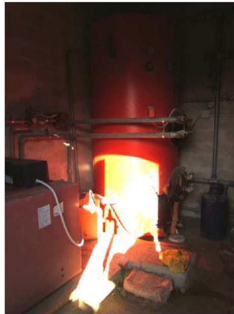
foto 8 Impianto Riscaldamento caldaia
