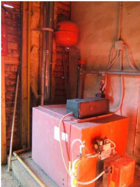
foto 7 Impianto Riscaldamento e acqua sanitaria
