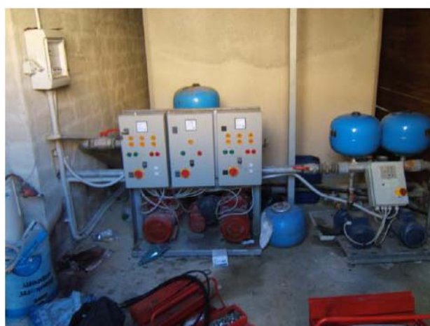
foto 6 Vano tecnico vista impianto idrico
