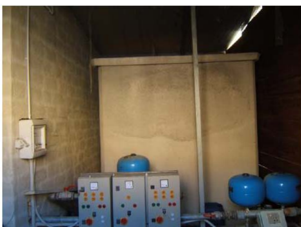
foto 5 Impianto idrico vista cisterne
