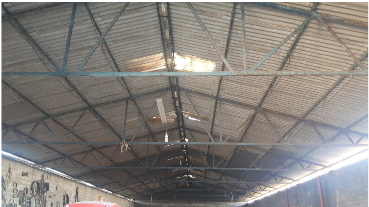
Foto n. 3. Particolare copertura in lastre di eternit del capannone industriale in Ribera, c/da Scirinda (part. n. 434, foglio di mappa n. 10).
