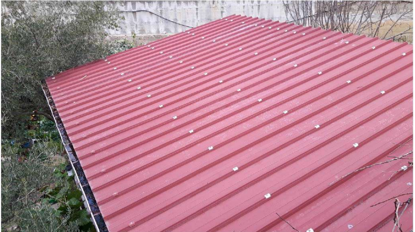
Foto n. 29. Fabbricato urbano in Sambuca di Sicilia, c/da Adragna (foglio 14, p.lla 260). Copertura terzo corpo di fabbrica (cantinola).
