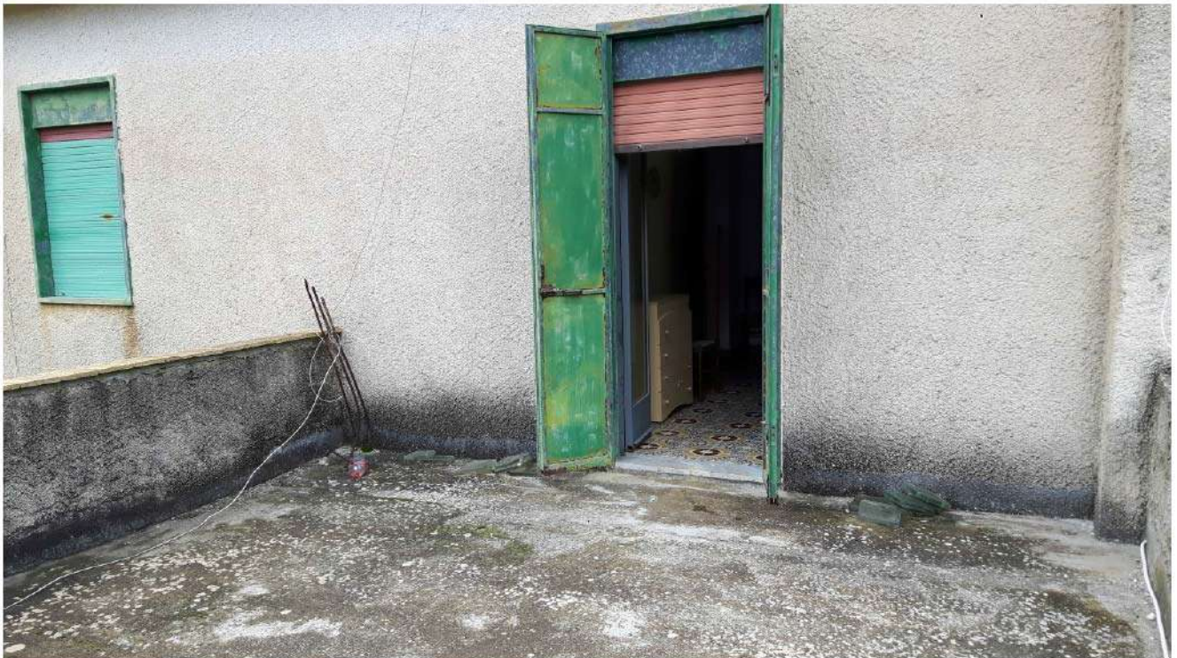
Foto n. 30. Fabbricato urbano in Sambuca di Sicilia, c/da Adragna (foglio 14, p.lla 260). Terrazza secondo corpo di fabbrica.
