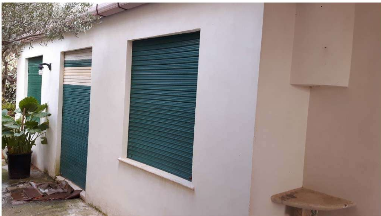
Foto n. 28. Fabbricato urbano in Sambuca di Sicilia, c/da Adragna (foglio 14, p.lla 260). Prospetto terzo corpo di fabbrica (cantinola).
