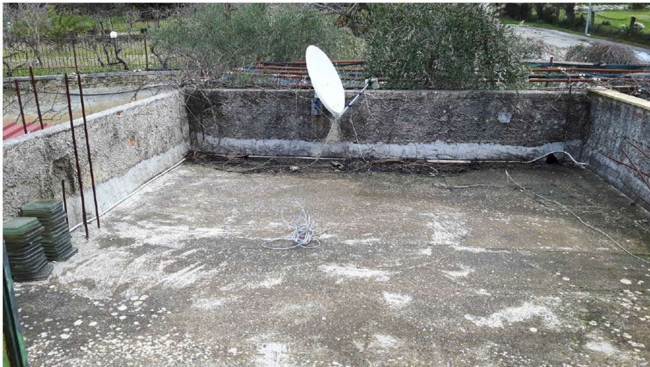
Foto n. 31. Fabbricato urbano in Sambuca di Sicilia, c/da Adragna (foglio 14, p.la 260). Terrazza secondo corpo di fabbrica.
