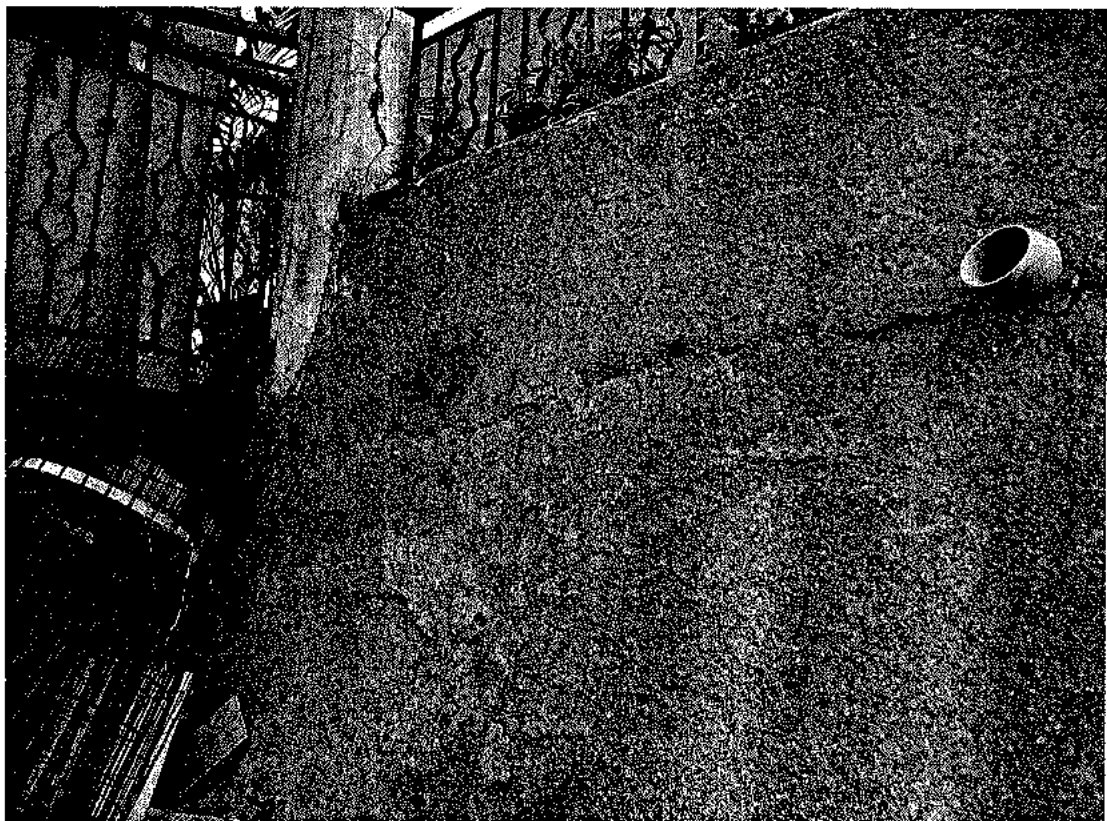
FOTO 20: Muro di sostegno a tergo del terrazzo con distaccamento del parapetto
